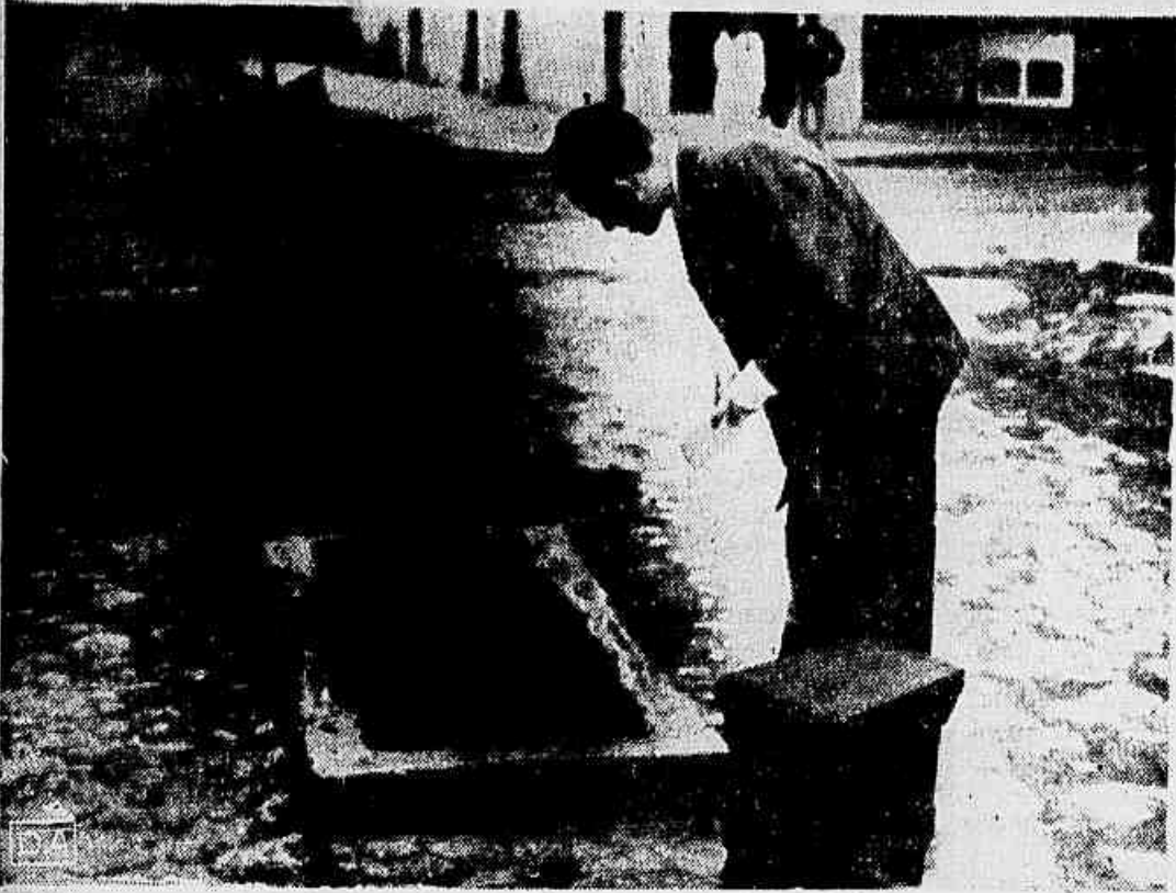
QUE BURACO! — Este enorme buraco encontra-se na rua Noronha Torresão, que liga Santa Rosa ao bairro do Fonseca, passando pelo Cubango. Trata-se de uma rua das mais movimentadas. Em determinadas ocasiões, o trânsito nessa via pública se ataraxa e torna-se sumamente perigoso. Só por um milagre ainda não se registraram ali graves desastres. As obras de reparações que estão sendo realizadas ali datam, segundo apuramos, de três anos.
