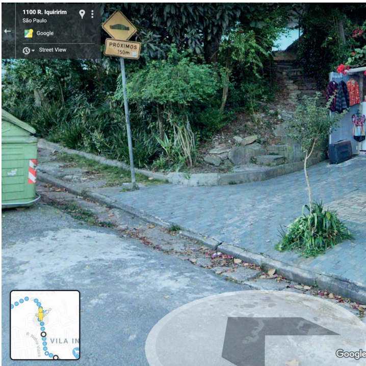
Figura 11. Detalhe da escada, bastante comprometida, ao lado de pracinha/ espaço remanescente da articulação entre ruas em desnível.
