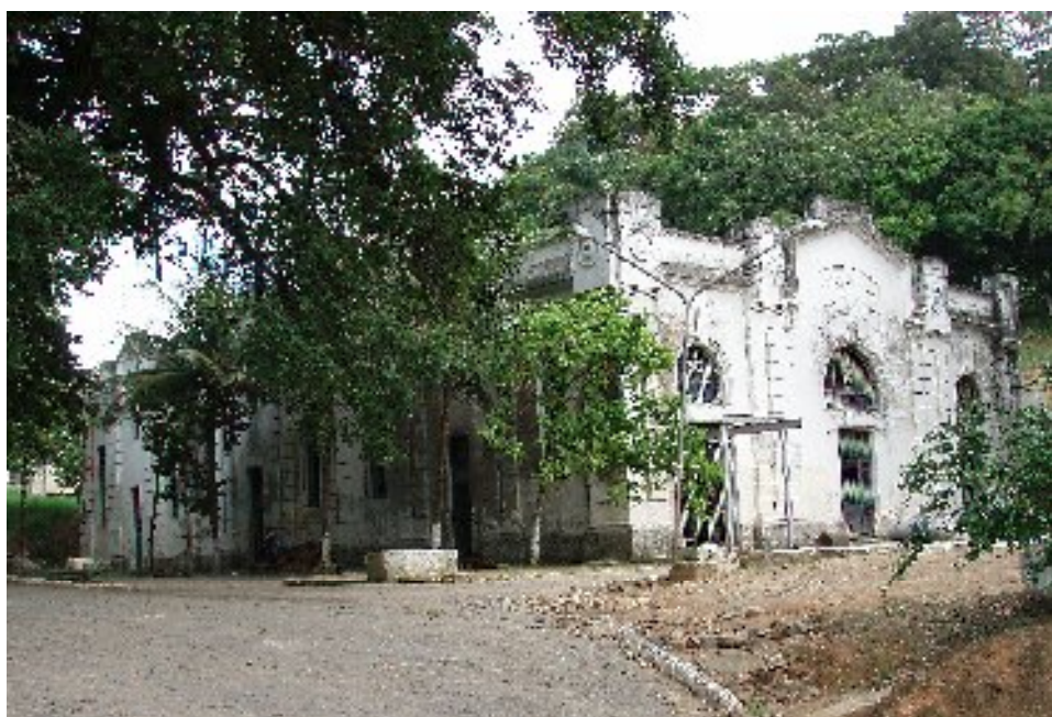
Figura 82: Casa dos filtros em Gurjaú – Cabo de Santo Agostinho – PE. Fonte: acervo do autor.
