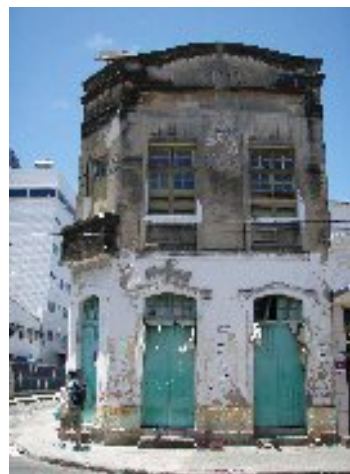
Figura 84: Edificação à rua dos Coelhos, 222. Bairro dos Coelhos – Recife – PE. Fonte: acervo do autor.
