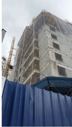
Figura 38. Exemplo de edifício em construção no bairro de Pinheiros na cidade de São Paulo (dez/2016): vedação externa em bloco de concreto. Fonte: acervo pessoal.
