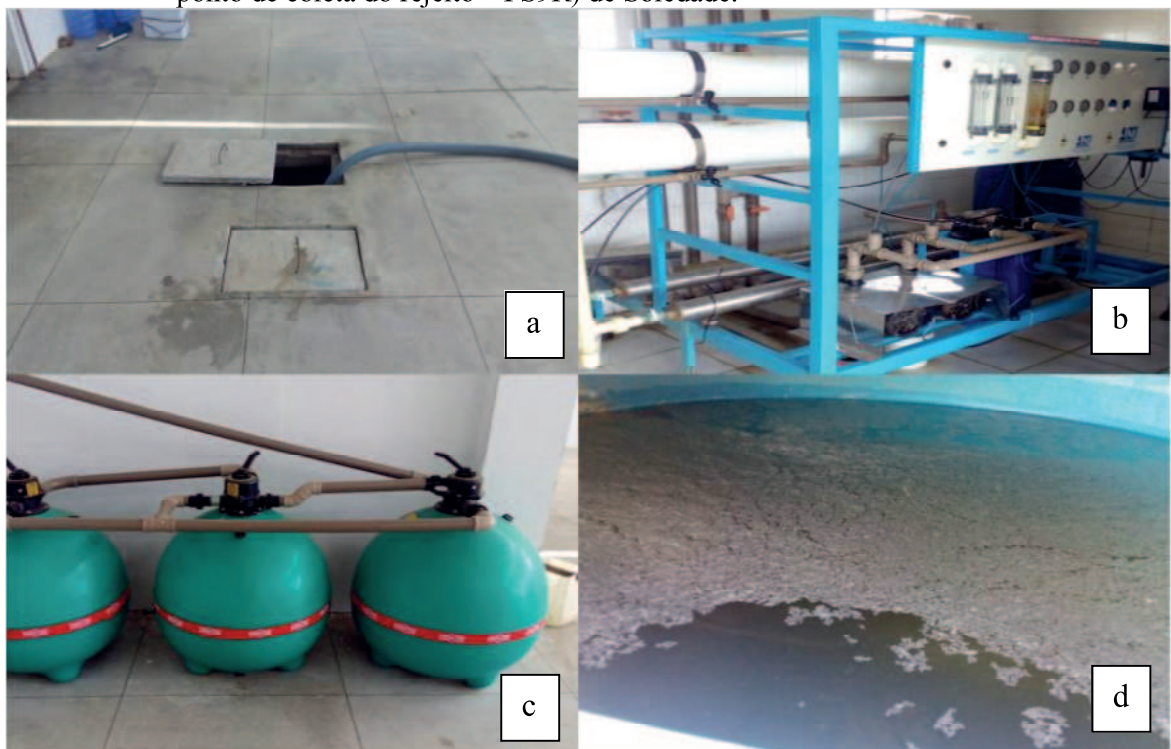
Figura 3.11 – Amostragem do poço PS9 (a - ponto de coleta de água bruta – PS9B; b - ponto de coleta de água dessalinizada – PS9D; c - ponto de coleta de água filtrada – PS9F; d - ponto de coleta do rejeito – PS9R) de Soledade.
